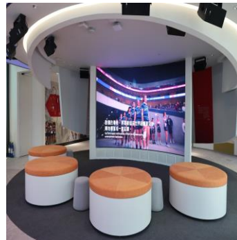
AV System at KTSP Project Gallery
